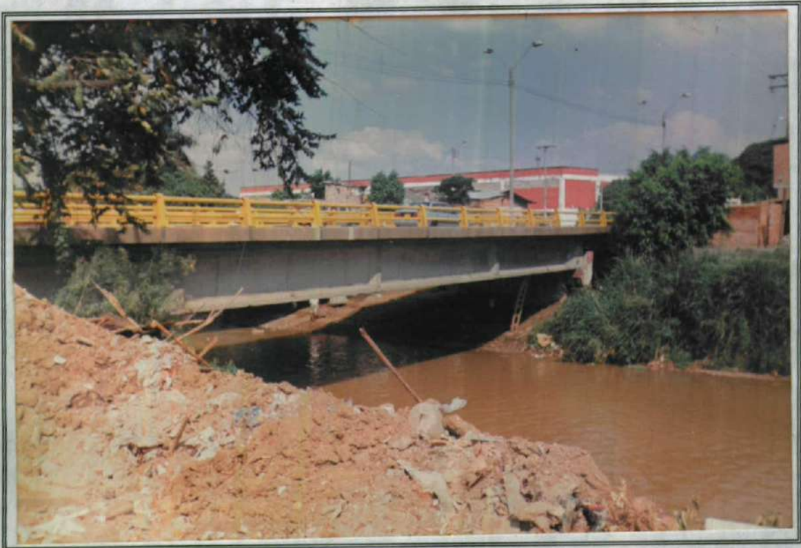
FOTOGRAFIA C30 Puente calle 52, sin muros a ambos lados.
