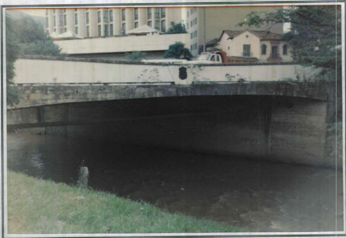
FOTOGRAFIA C24 Puente 3 Norte cerca a Hotel Valle Real
