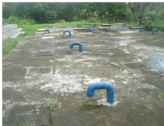
Foto 3. Tanque séptico tercer línea
