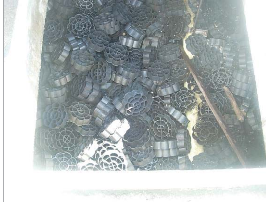
Foto 4. Rosetas plásticas de filtro anaerobio
