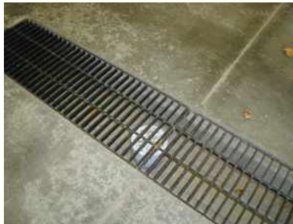
Ilustración 15. Drenaje que utilizan en los cubiles de los leones, osos y lémures que debería usar el cubil de las nutrias
