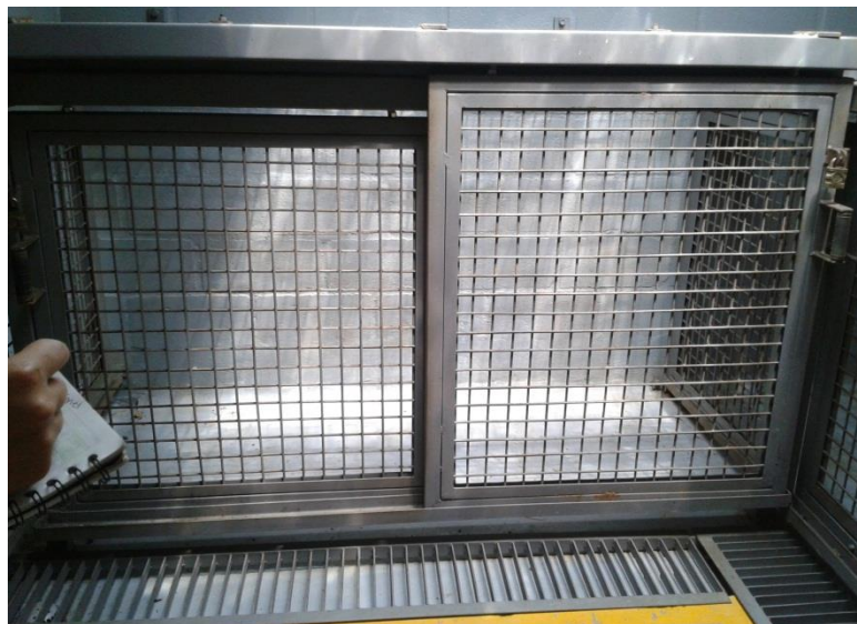
Ilustración 4. Imagen que evidencia que no se cumple con los parámetros mínimos de las mallas y barrotes
