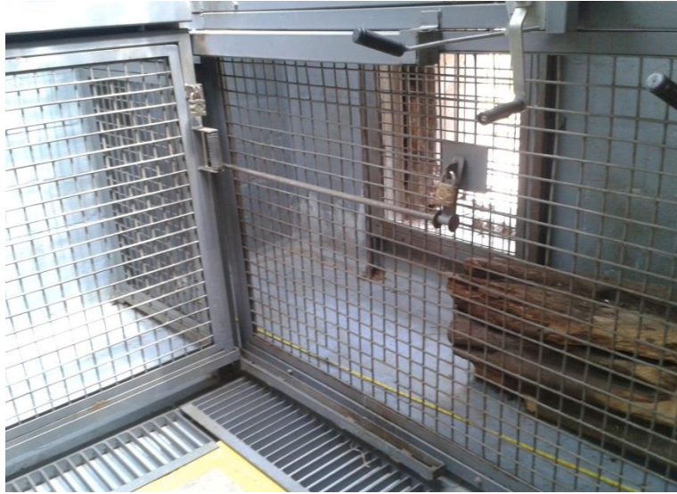
Ilustración 3. Imagen que evidencia que no se cumple con los parámetros mínimos de las mallas y barrotes.
